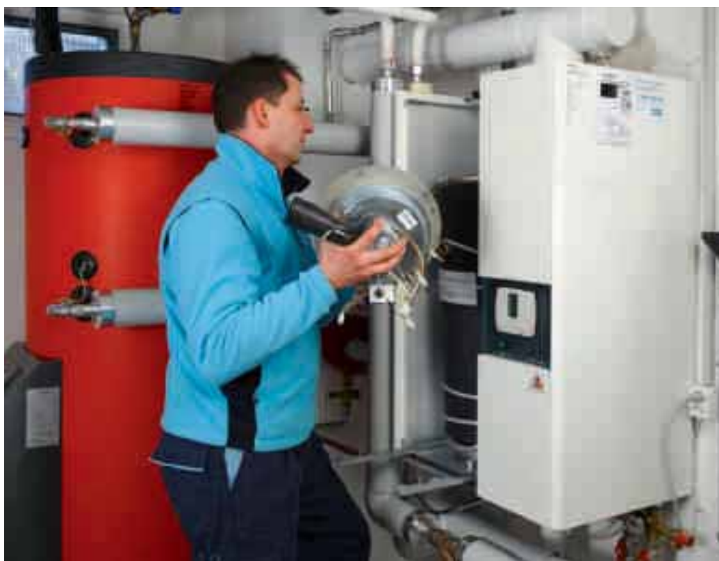
Die von Euw AG Heizungen aus Grüningen setzt...
